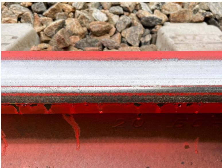
Foto 4: Oslipad ytterräl i kurvan vid mätplats Gånghester
