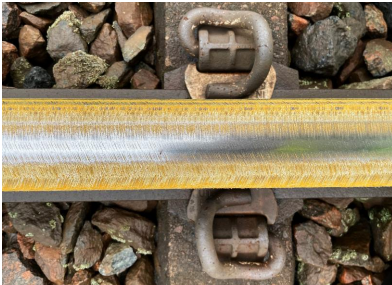
Foto 3: Nyslipad ytterräl i kurvan vid mätplats Hindås
